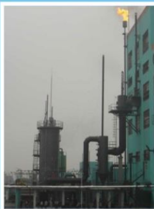
▲ 12MW机组示范
